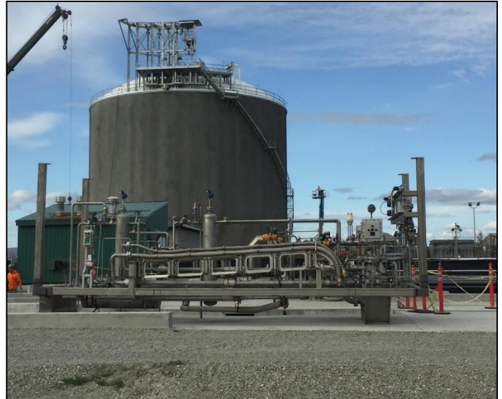
LNG Transfer Skid
